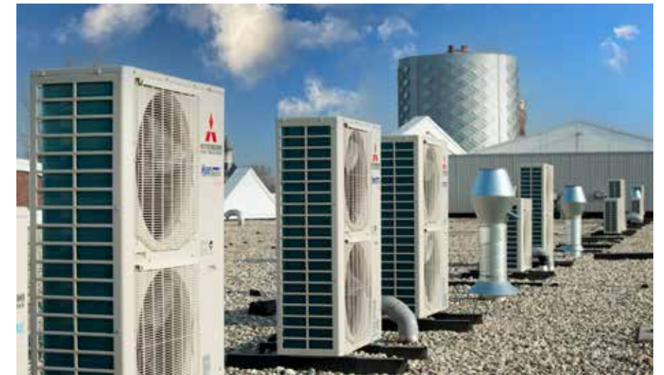
Luchtbehandelingskasten op het dak van het outletcentrum.
