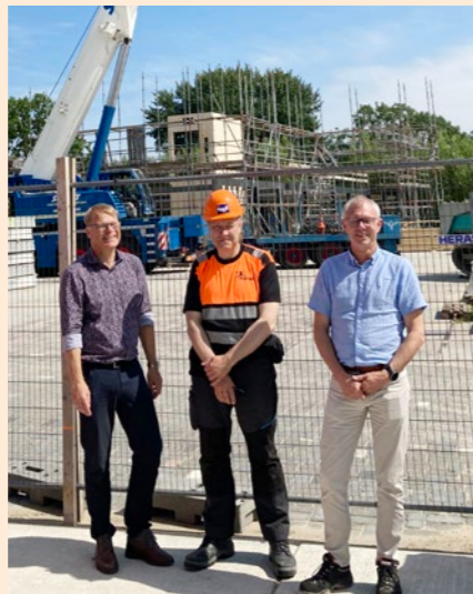
Portier (m) SROI bij project IKEC in Hoorn
